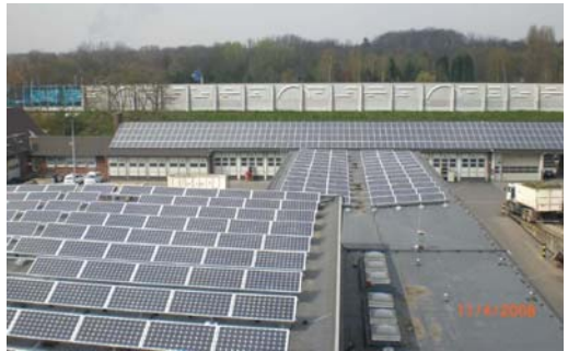
Een deel van de PV-installatie van Gelsendienstean aan de AdenauerAllee te Gelsenkirchen
