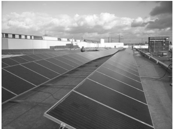
De 250 Kilowattpiek-installatie in Gelsenkirchen
