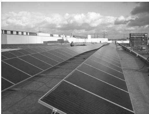
Zonnepanelen op het dak van Scheuten Solar Systems
